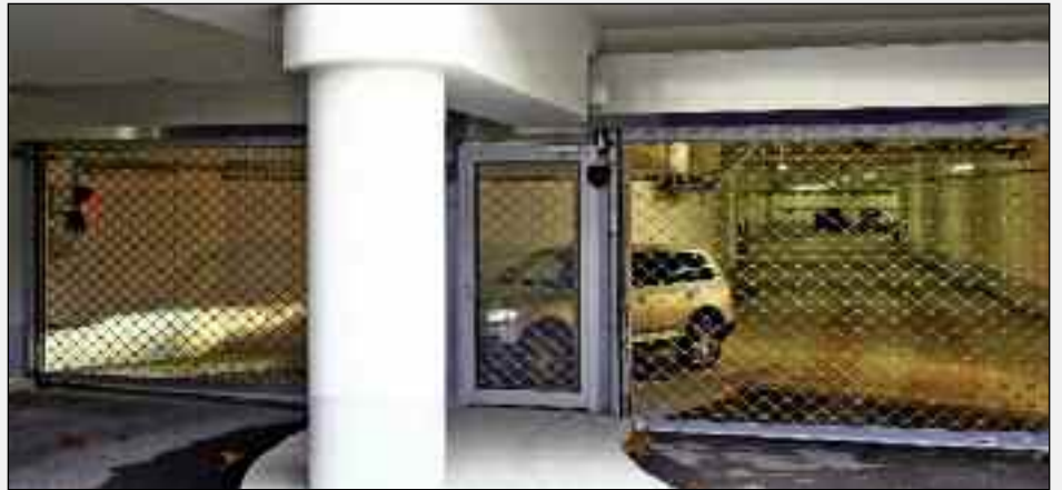
Rollgitter TG-A in einer Tiefgarage.
